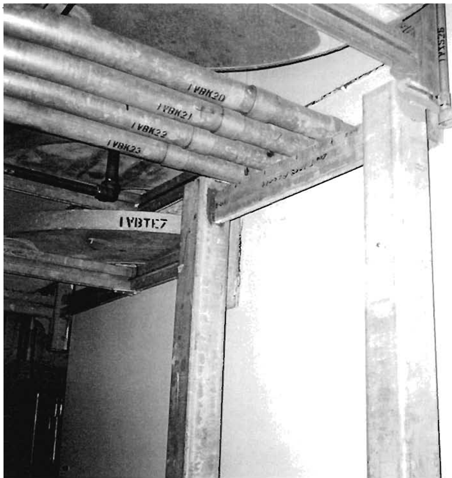
Plate 8-12 : Conduit support, San Onofre NPP
