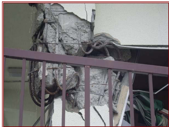
(d) Shear failure of column (1 st storey level)
